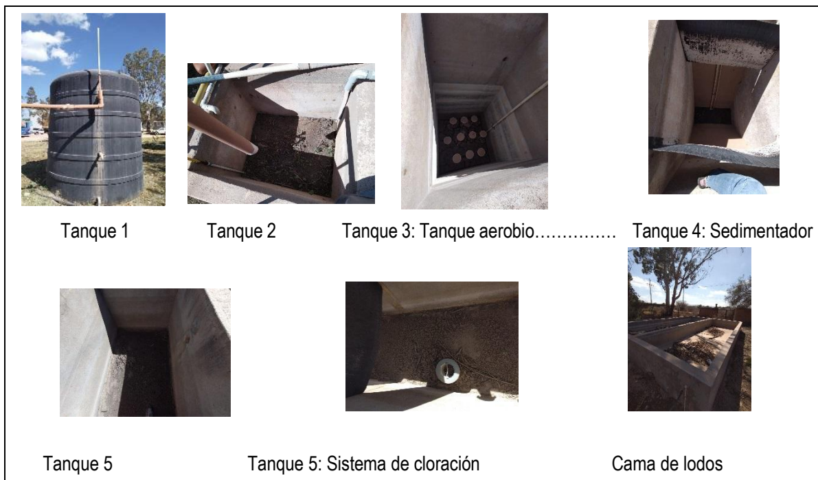
Figura 29. Vista de procesos PTAR FAV
