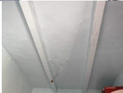
Imagen 58-60. Deterioros presentes en instalaciones hidráulica y eléctrica de vivienda 7. Fuente: dictamen de unidades de análisis. Imágenes: propias.
