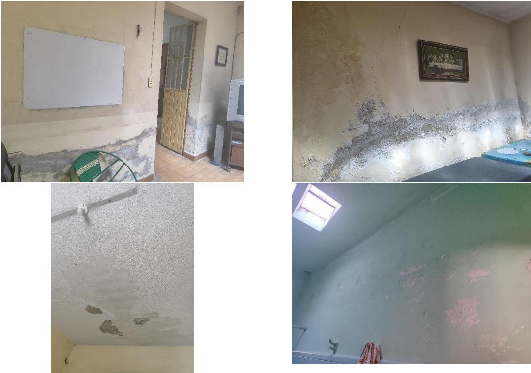
Imagen 25-28. Deterioros presentes en muros y techo de vivienda 5.
