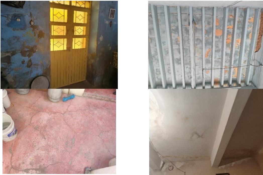
Imagen 45-48. Deterioros presentes en muros, techos, vigas y piso de vivienda 10. Fuente: dictamen de unidades de análisis. Imágenes: propias
