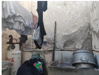
Imagen 53-55. Deterioros presentes en instalaciones hidráulica y eléctrica de vivienda 2. Fuente: dictamen de unidades de análisis. Imágenes: propias.
