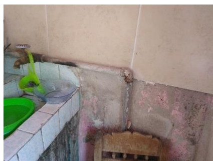
Imagen 50-52. Deterioros presentes en instalaciones hidráulica y eléctrica de vivienda 1. Fuente: dictamen de unidades de análisis. Imágenes: propias.
