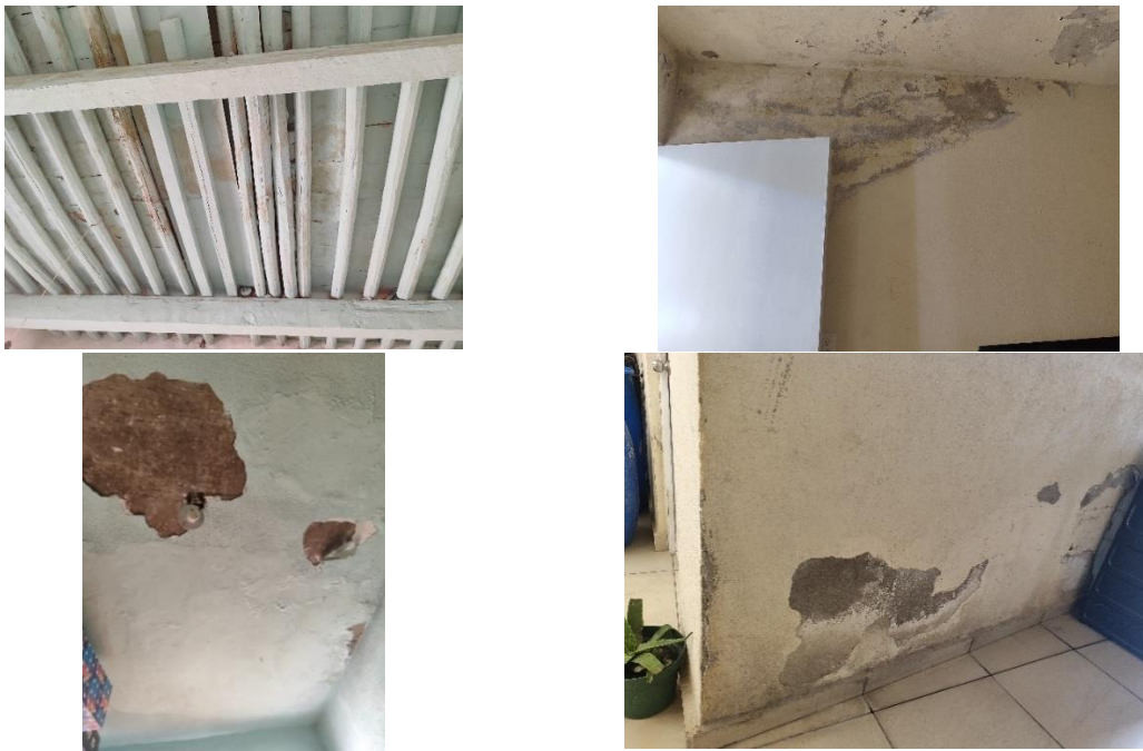
Imagen 41-44. Deterioros presentes en muros, techos y vigas de vivienda 9. Fuente: dictamen de unidades de análisis. Imágenes: propias
