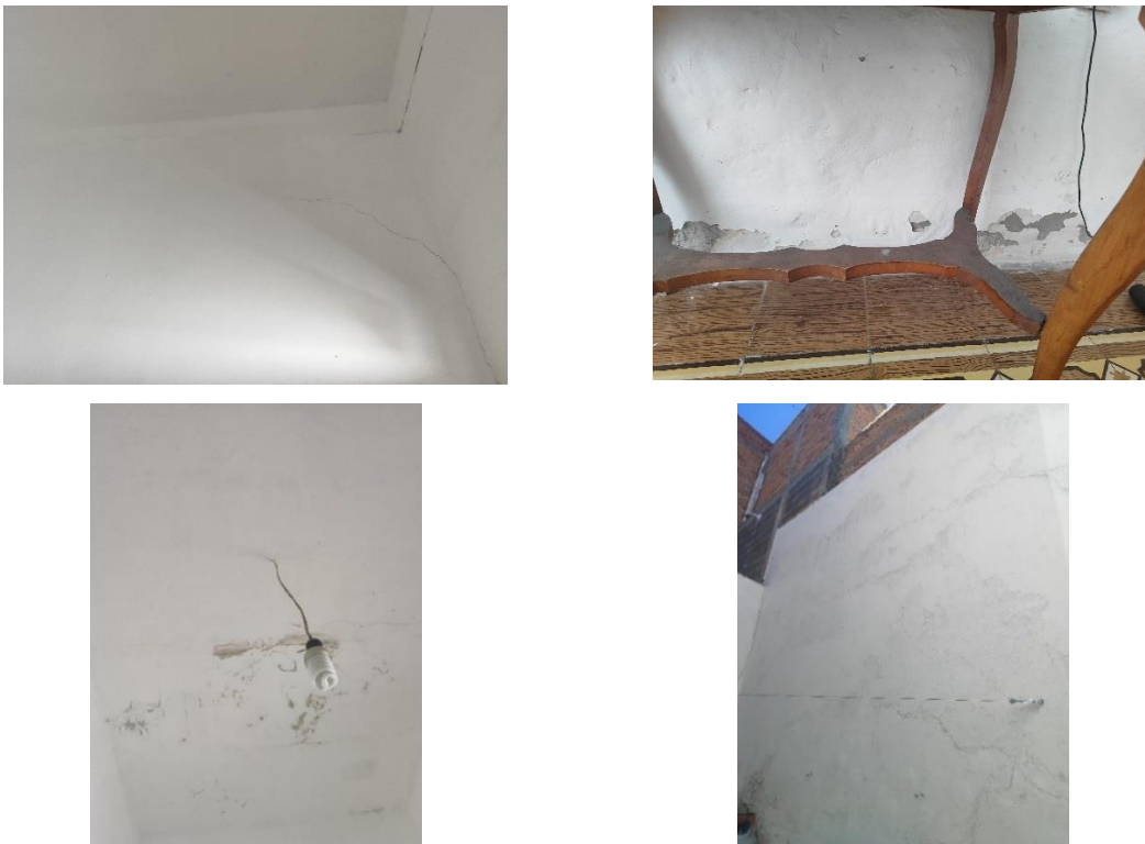
Imagen 21-24. Deterioros presentes en muros de vivienda 4. Fuente: dictamen de unidades de análisis. Imágenes: propias
