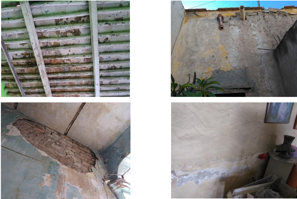
Imagen 9-12. Deterioros presentes en muros, techo y vigas de vivienda 1.
