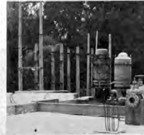
EN FUNCIONAMIENTO.— La mayor parte de los pozos que surten de agua a la ciudad fueron equipados...
