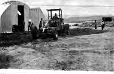
Adiantadas se encuentran las obras de construcción de la Proveedoría Electrónica de Zinc, arena y Fundidora de Molybdeno.
