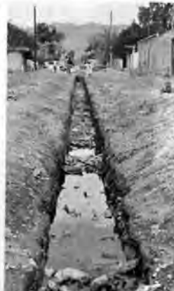
FOCO INFECCIOSO.— A la altura de las calles Luis García y Juan Cerro existe esta zanja abierta, la cual es un potencial foco infeccioso y causa del agua estancada y la bacteria.
