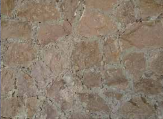
Detalle de muro de mampostería, juntada con mezcla cal-arena, Auditorio Miguel Barragán. Foto: Jesús Villar.
