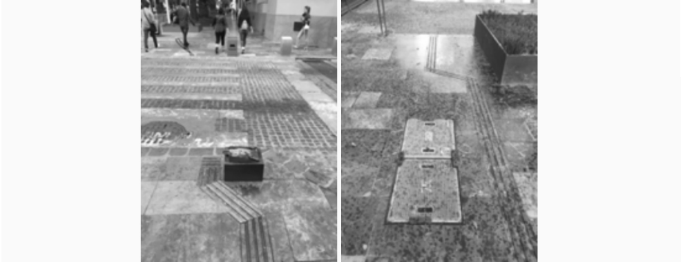
Imagen 4: Pérdida de continuidad de la huella podotáctil. Foto: autores, 2019.
