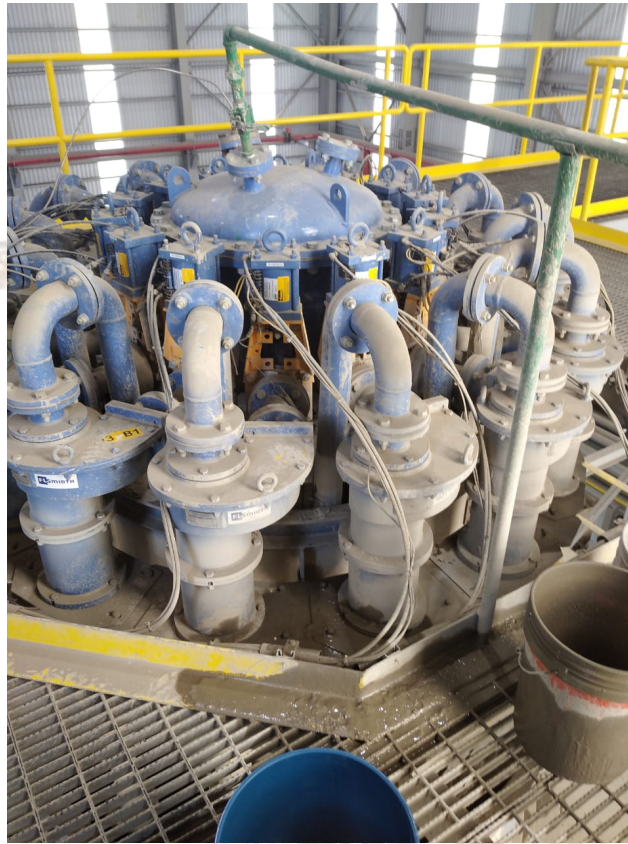
Figura 4. Batería de hidrociclones de planta Piratas de Fresnillo PLC.
