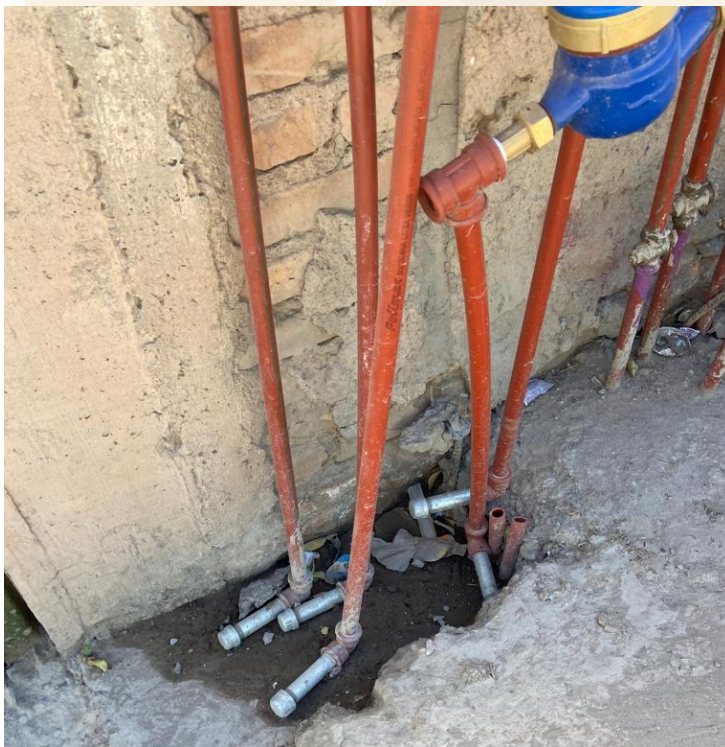
Figura 21. Fotografía de tomas domiciliadas de agua sin conectar a la vivienda en Escalerillas S.L.P. Fuente: Captura personal en una visita a la región, 2024.
