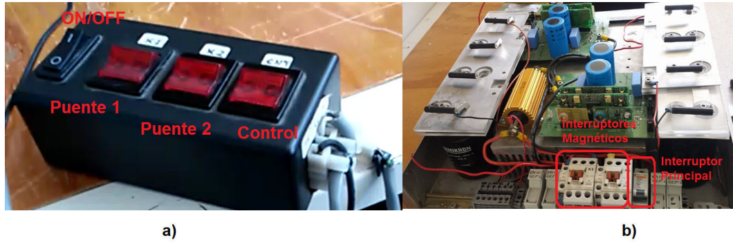
Figura 6.15: a) Mando principal de control b) Interruptores termomagnéticos y switch principal
