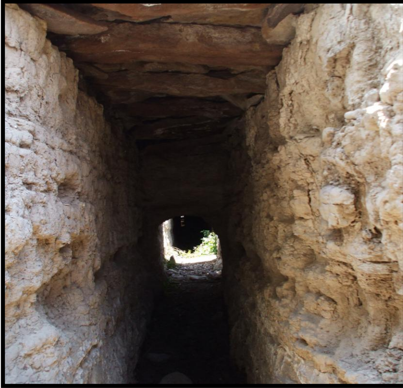
Ilustración 6. Estructura reforzada en una de las lumbreras, Cañada del Lobo, julio 2012.
