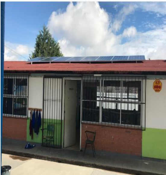
Figura 30. Celdas fotovoltaicas instaladas en uno de los edificios de la escuela
