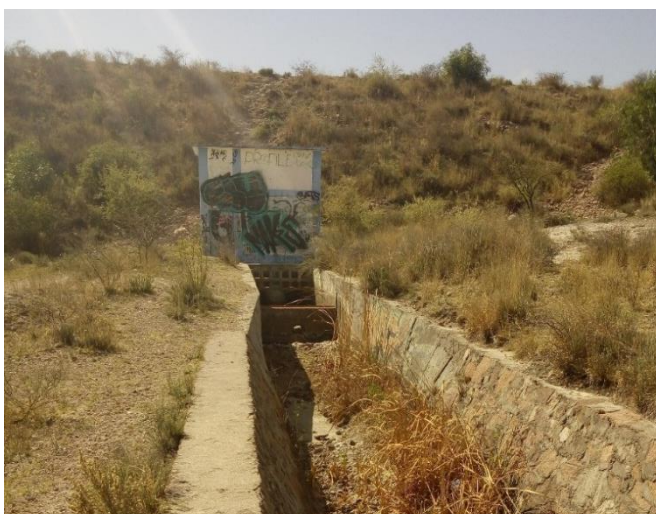
Figura. 26. Exterior de la caseta en donde se encuentra el sistema hidráulico que controla el flujo de la Presa Cañada de Lobo, acervo personal, 14 de marzo de 2016.
