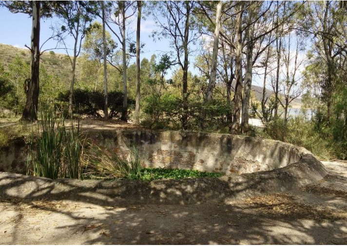
Figura. 21. Parte superior del reservorio de agua del antiguo sistema de abastecimiento de la Ciudad de San Luis Potosí “Cañada de Lobo”, acervo personal, 20 de septiembre de 2015.
