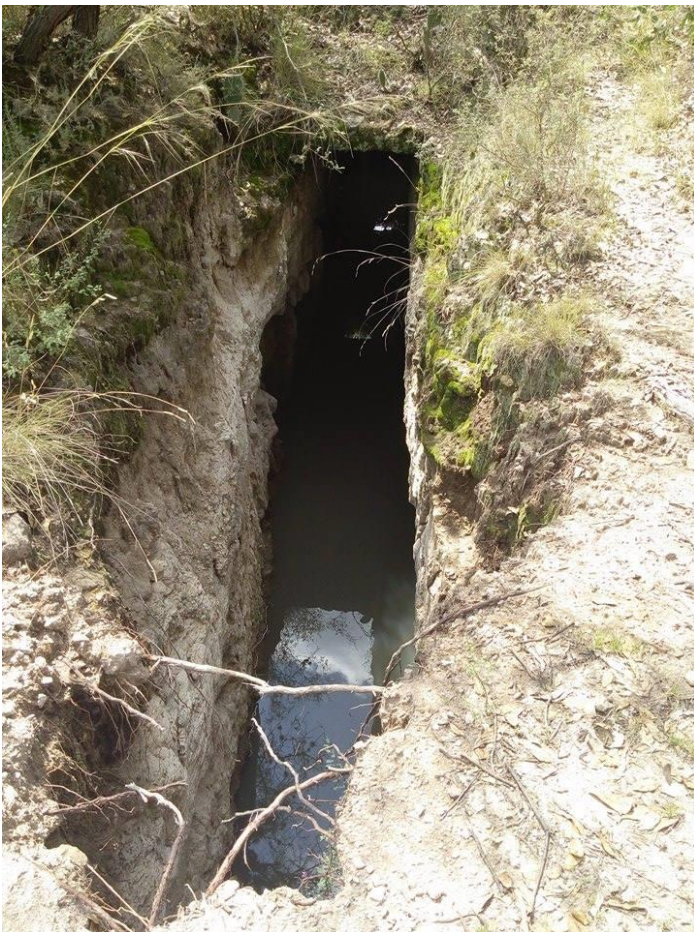
Figura. 22. . Galería filtrante del antiguo sistema de abastecimiento de agua de la Ciudad de San Luis Potosí. Acervo personal, 20 de septiembre de 2015.
