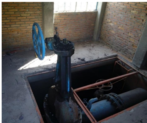
Figura. 25. Interior de la caseta en donde se encuentra el sistema hidráulico que controla el flujo de la Presa Cañada de Lobo, acervo personal, 14 de marzo de 2016.
