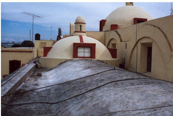
26. Aspecto de la bóveda y la cúpula que actualmente cubren la capilla de Loreto. Fotografía. JAHS
