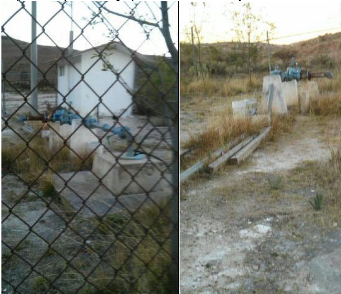
Imagen 9: Pozo profundo de agua potable de Mesa de los Conejos.
