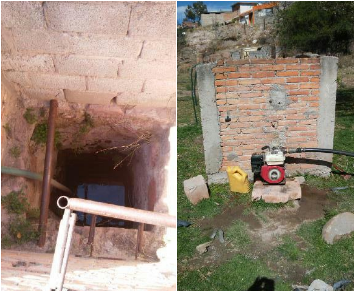
Imagen 8: Pozo perforado por un particular.
