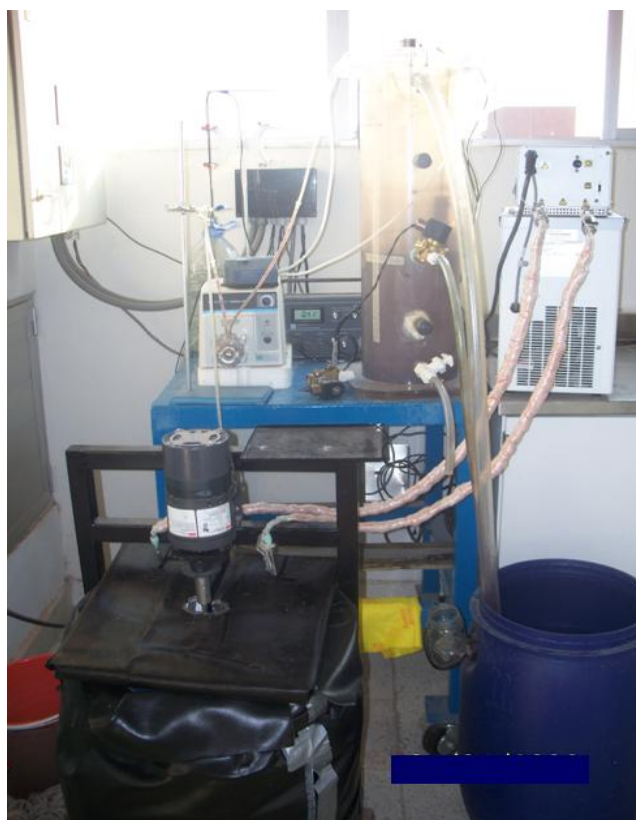
Figura 3.7. Sistema refrigerante acoplado al depósito de almacenamiento.
