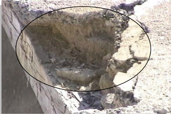
Imagen No. 4.65 Vista en detalle de la techumbre de tejamanil perteneciente a la crujía oriente, nótese los grosores tanto del terrado como de la capa de compresión fabricada con cal y grasa de beneficio
