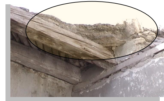
Imagen No. 4.64 Vista de techumbre de tejamanil perteneciente a la crujía oriente donde puede observarse la maza del entortado constituido con mezcla de cal y grasa del beneficio, formando lo que podríamos llamar un concreto de cal.
