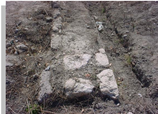
Imagen No. 4.20 Vista de la corona de cimentación de mampostería corrida con aparejo ordinario
