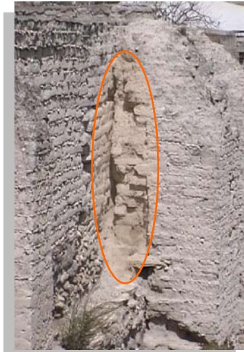
Imagen No. 4.43 Detalle de la unión de contrafuerte al muro de carga en donde se puede apreciar que no existe cuatrapeo entre ambos elementos estructurales
