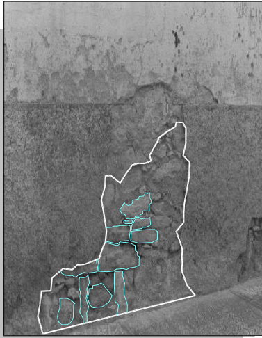
Imagen No. 3.6 Vista de una reparación típica en un muro donde se emplea la piedra caliza y rajuelas de tepetate
