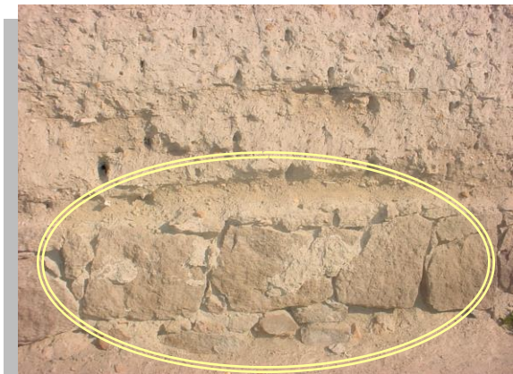
Imagen No. 8 Vista de cimentación de piedra donde se observa el desplante del muro de adobe en una vivienda del barrio de San Sebastián
