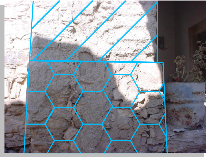
Imagen No. 4.38 Acercamiento de uno de las pilastras que sostienen el arco de acceso a los dos patios, donde se puede observar la cimentación y el muro de adobe con restos de las diferentes reparaciones sufridas.
