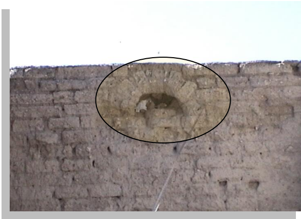
Imagen No. 4.54 Vista de arco de descarga formado por piezas estándar de adobe.
