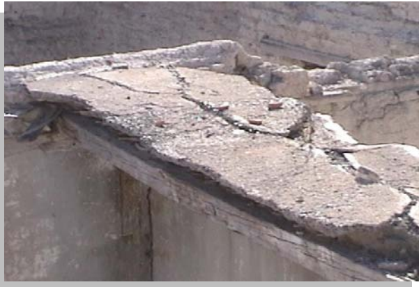
Imagen No. 4.69 Vista del estado actual de la techumbre de las crujiás poniente donde se aprecia el terminado de la azotea antigua.
