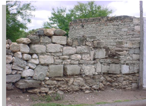
Imagen No. 3.17 Vista del aparejo casuístico a base de piedra en un muro típico de la región, perteneciente a una casa habitación en donde se aprecia la inexistencia de mortero en las juntas de las mismas.
