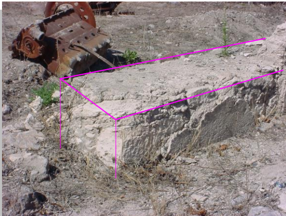
Imagen No. 4.23 Vista de la corona de cimentación de mampostería en donde se observa el lecho que apoyó al ya desaparecido muro de adobe y su desplante a nivel, así como restos de su aplanado.
