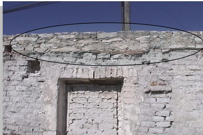
Imagen No. 4.72 Vista del pretil de piedra sobre muro cuya techumbre ha colapsado en la Hacienda del Refugio
