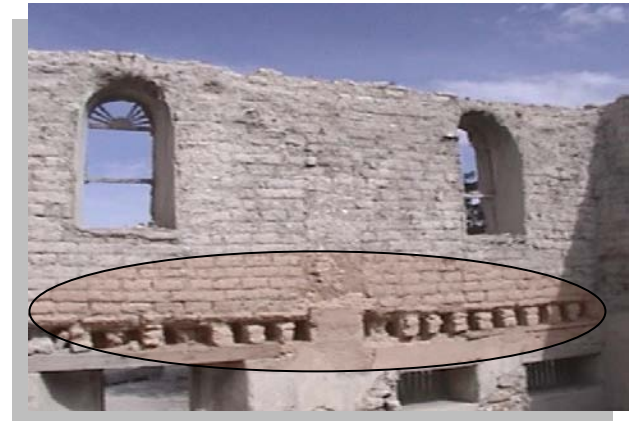
Imagen No. 4.73 Vista interior de la crujía poniente donde puede apreciarse los huecos de las vigas de un pequeño entrepiso ya desaparecido.
