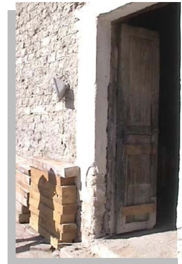
Imagen No. 4.77 Vista del enmarcamiento de tabique de una de las puertas de la crujía norte
