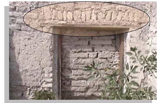
Imagen No. 4.45 Vista del Cerramiento de platabanda dovelada o arco adintelado. Obsérvese que este se encuentra sobre un dintel de madera de una puerta en la crujía poniente.
