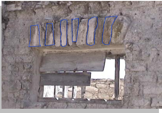
Imagen No. 4.48 Detalle de un dinte de dovelado fabricado con piedra caliza, el cual se distingue por la utilización de este material en comparación con el adobe que domina toda la obra.
