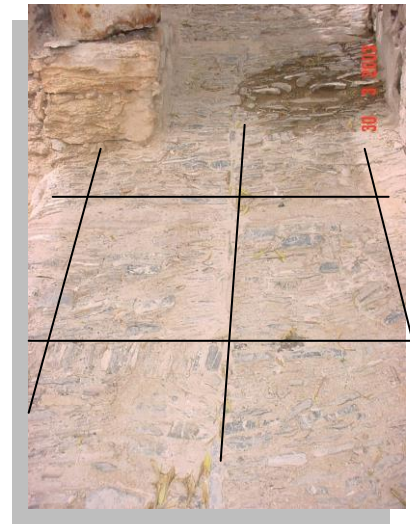
Imagen No. 4.78 Vista de pisos rajueleados en rampas de acceso al patio principal
