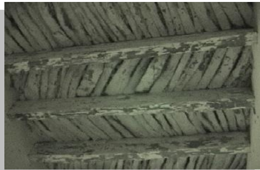
Imagen No. 4.67 Vista de la techumbre de viguería y tejamanil de la crujía norte, donde se puede observar la separación de las vigas y la colocación diagonal del tejamanil
