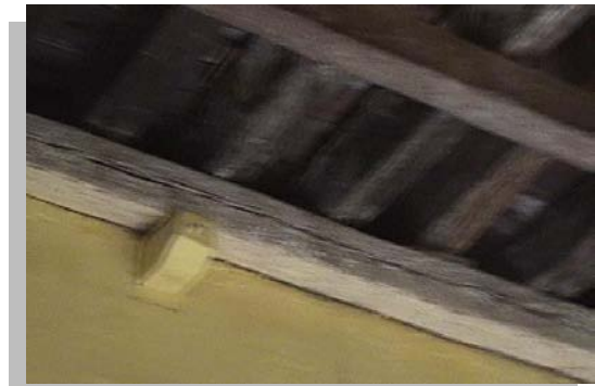
Imagen No. 4.66 Vista de vigas maderas adosadas al muro y apoyadas sobre canes de madera para reforzar los cabezales de las vigas principales
