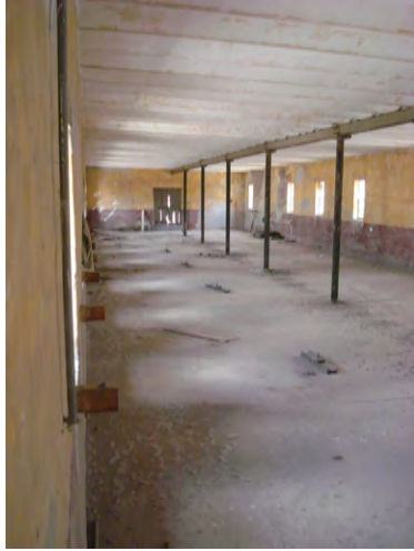
Figura 14. Fotografía tomada por ARV en noviembre de 2010, Vista interior del segundo nivel, se puede notar el sistema de planta libre.
