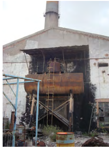
Figura 26. Fotografía tomada por ARV en noviembre del 2010. Tanque para combustible de las calderas.
