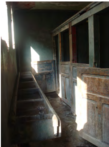
Figura 39. Fotografía tomada por ARV en noviembre de 2009. Imagen de los sanitarios de inicios de la fábrica, en un comienzo eran letrinas y hasta la inclusión del drenaje a la fábrica posiblemente en la década de los cuarenta se les colocó inodoro.
