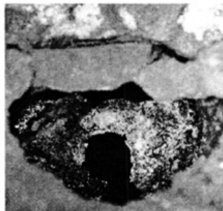
Lámina 1.9 Fuga por corrosión. (OPS, Organización panamericana de la salud Fugas y Medidores.).
