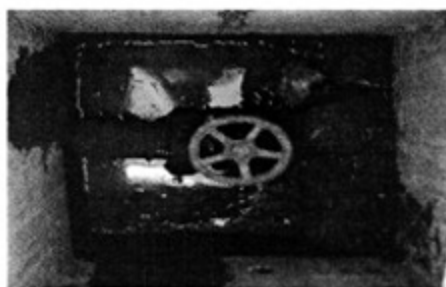
Lámina 1.10 Fuga en caja de válvula.
