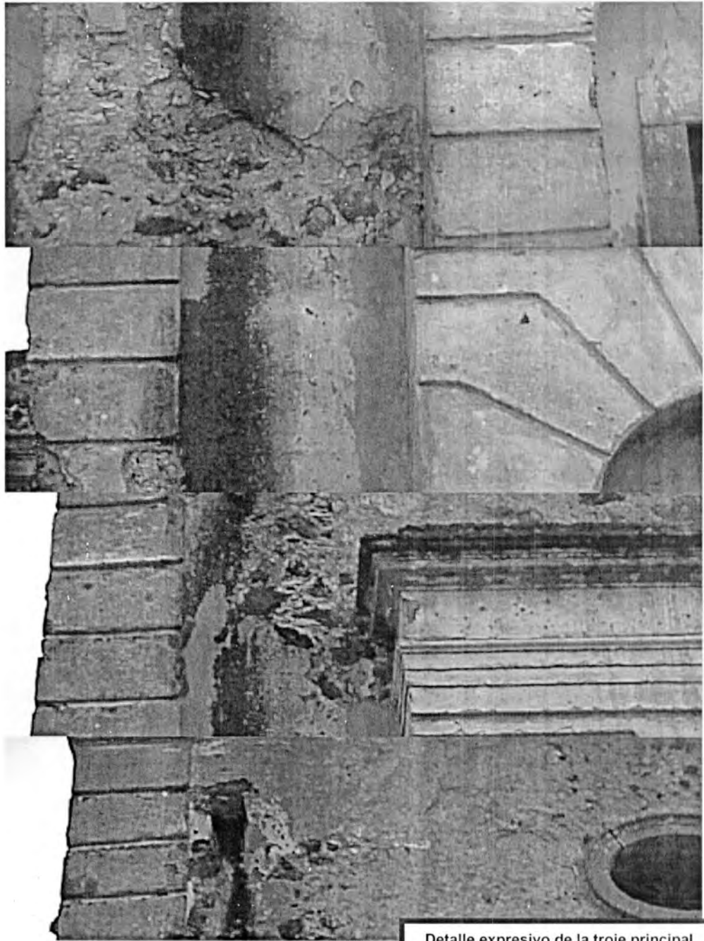
Detalle expresivo de la troje principal de la ex hacienda La Corcovada
