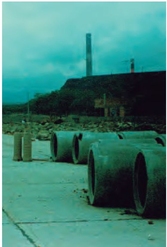
Stormwater collector pipes | Tubería de colector pluvial
