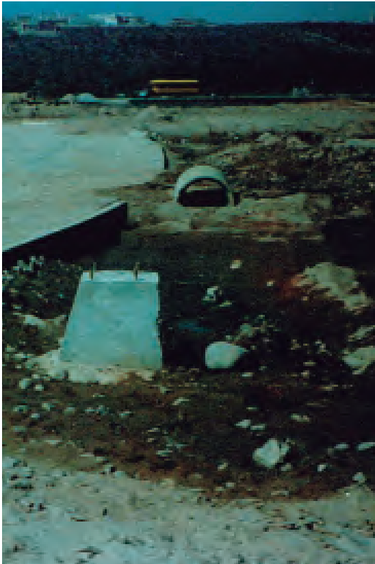
Lamp post base | Base para poste
