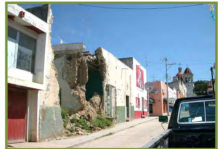
Ejemplo vivienda en deterioro/ calle Gral. Ignacio Zaragoza. Fotografía: No. 62, 63 / H.L.V.P.
